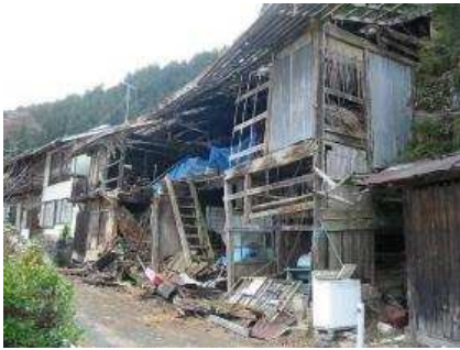
倒壊のおそれのある空き家
