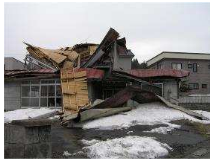
積雪により屋根が落下した空き家
