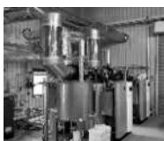
高効率ボイラー
