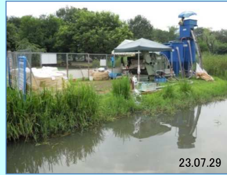
23.07.29 工事名:清瀬金山緑地公園池浚渫工事 工事場所:清瀬金山緑地公園/東京都清瀬市中里 発注者:東京都清瀬市役所
