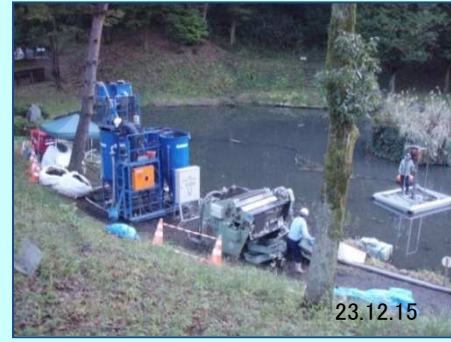
23.12.15 工事名:東京薬科大学池しゅんせつ工事 工事場所:東京都八王子市堀之内 発注者:学校法人東京薬科大学
