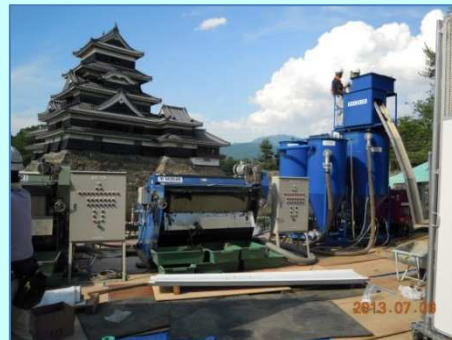
2013.07.09 工事名:史跡松本城(内堀)保存整備事業堆積物除去(しゅんせつ)工事 工事場所:松本城(内堀)/長野県松本市丸の内 発注者:松本市役所
