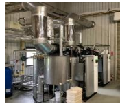
高効率ボイラー
