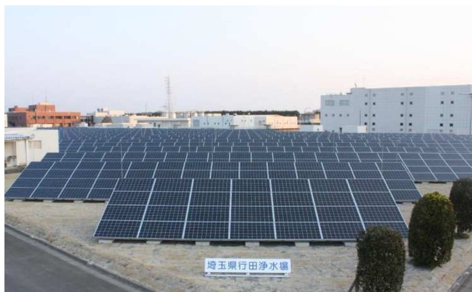
行田浄水場 太陽光発電設備（メガソーラー）
