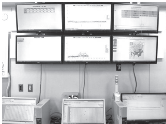
県庁でリアルタイム監視
