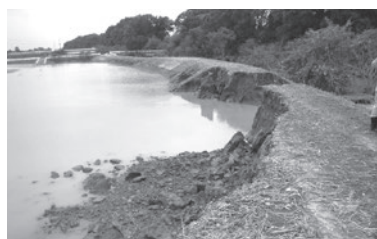
新江川(復旧前)
