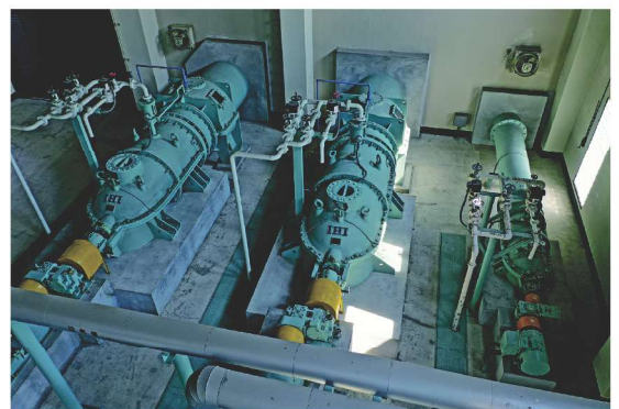
▲ 機場内部。右から1号、2号、3号ポンプ
