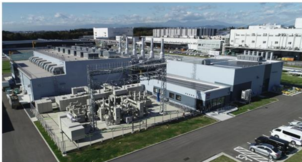
清原スマートエネルギーセンター
