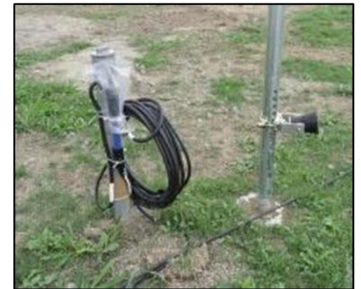
観測機器(水位・沈下)
