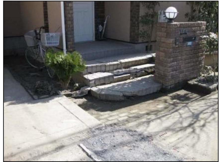
沈下による階段の破損
