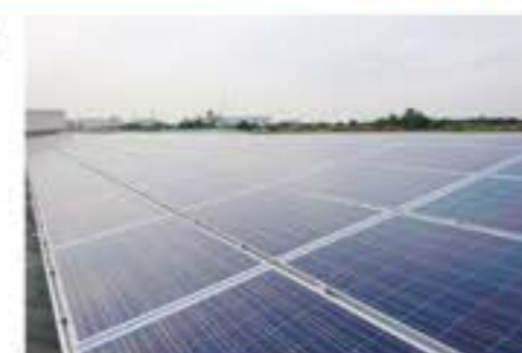
太陽光パネル (中川水循環センター)
