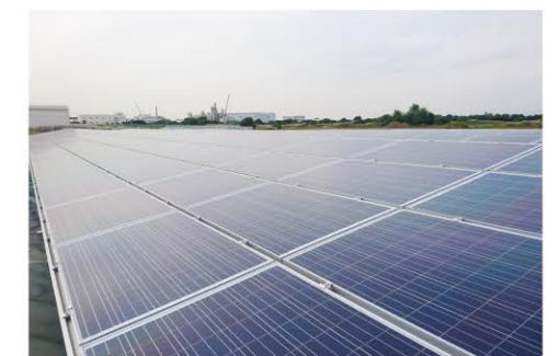
太陽光パネル（中川水循環センター）
