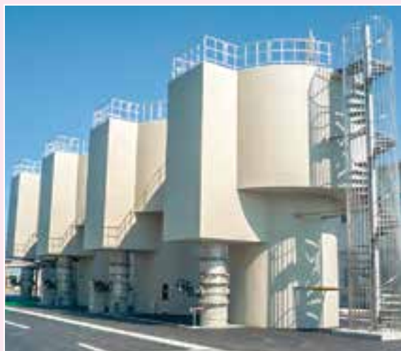
高度浄水処理施設
