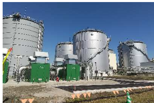
【写真】 消化タンク（中央・右）、ガスタンク（左）、発電機（手前）
