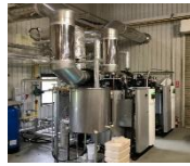
高効率ボイラー
