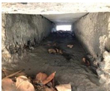
土砂が堆積した下水管
