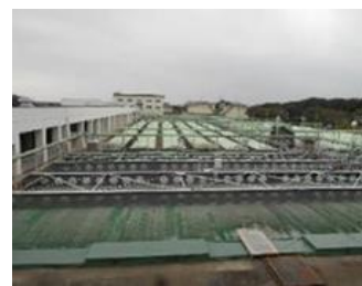
古利根川水循環センター 反応槽機械設備
