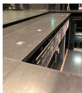
舞台設備（床機構）
