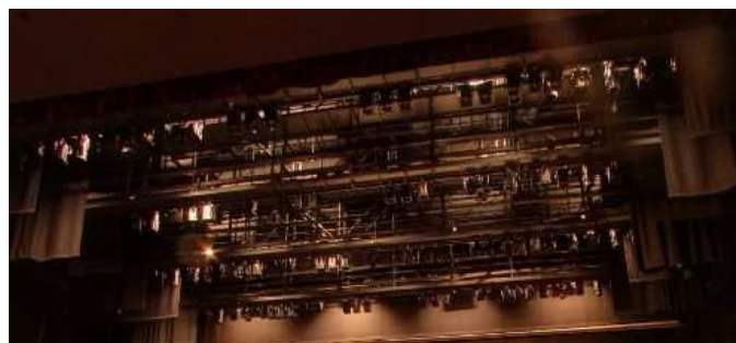
舞台設備（吊物機構）
