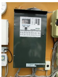
統合環境制御装置
