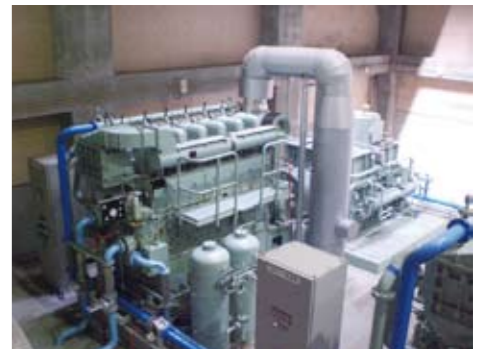
排水ポンプ設備
