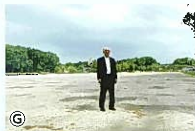
G地点から南を望む。調整池の整備が急ピッチで進められています。
