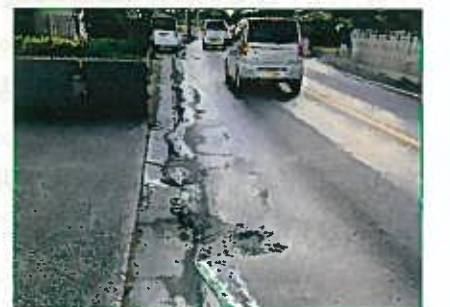
補修を繰り返している既存の県道
