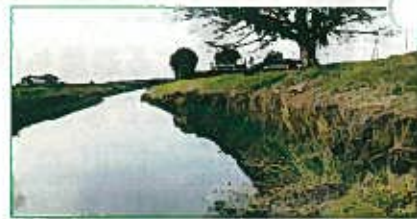
今にも崩れそうな中川護岸(北運沼地区より)
