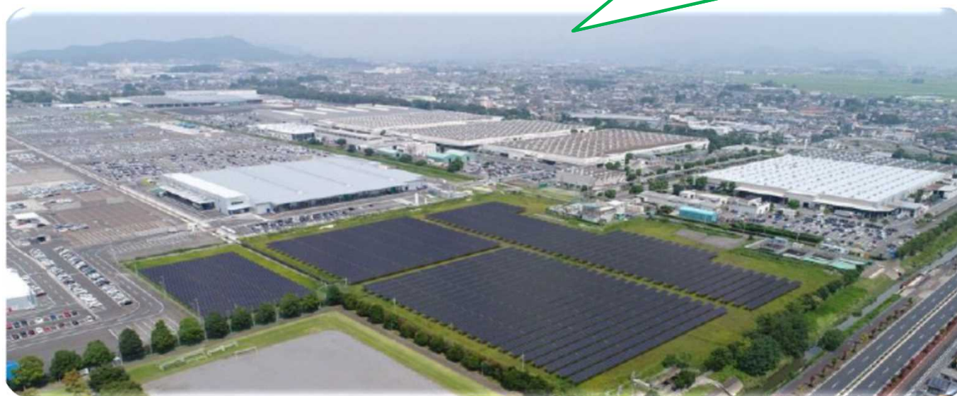
SUBARU 大泉工場さま 太陽光発電設備
