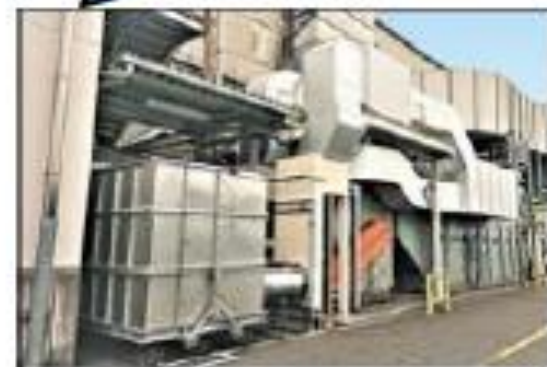
工場内塗装工程リサイクル空調 ⇒除湿・加熱負荷削減
