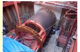
下水道施設の耐震
