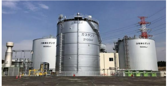
元荒川水循環センターの汚泥消化槽
