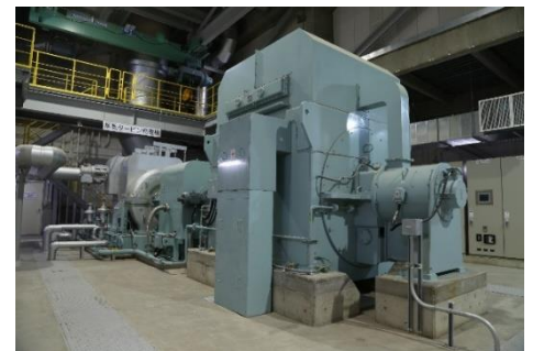
熱回収設備（蒸気タービン発電設備）
