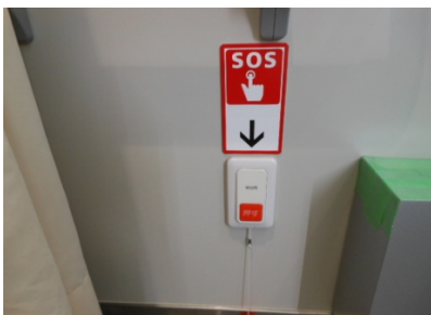
●非常警報装置
