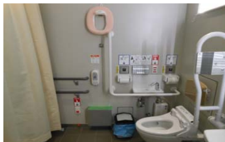
●便器付近の様子
