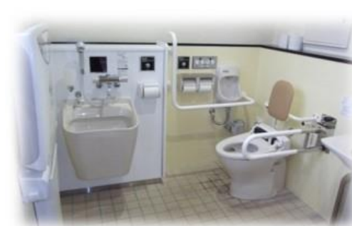
障害者対応型トイレ
