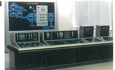
運転・操作設備
