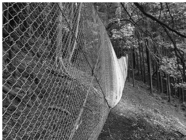
落石を山麓で捉える緩衝柵 (平成26年度上久通予防治山工事)
