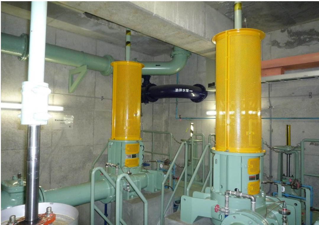
沈砂池ポンプ
