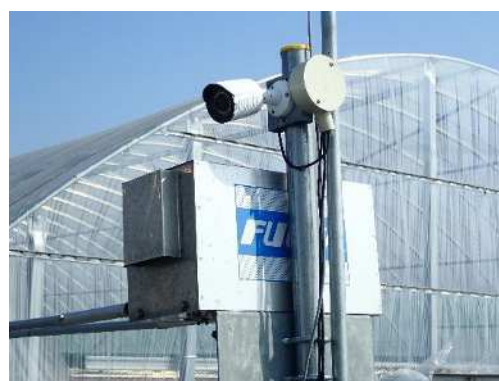
防犯カメラの設置
