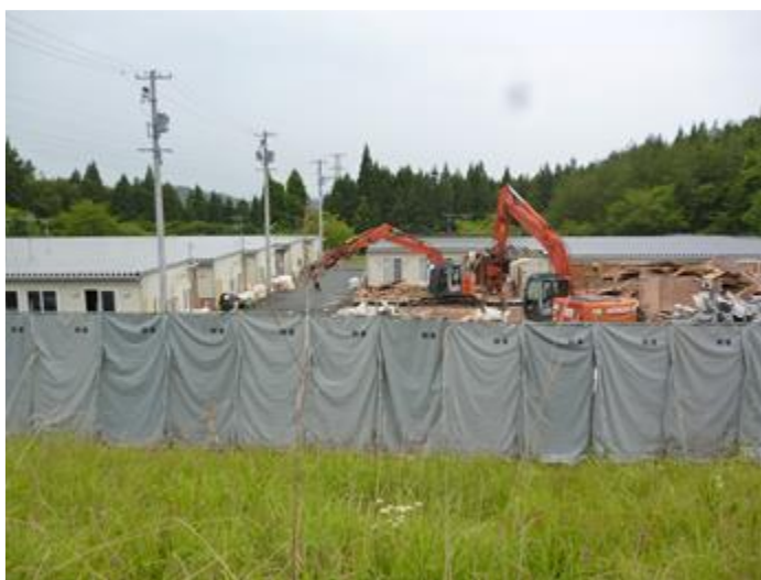
気仙沼市営テニスコートに建設された応急仮設住宅の解体現場
