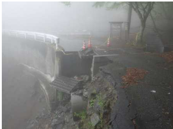
令和元年被災箇所（R4.4）
