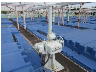
荒川水循環センター 水処理設備
