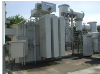
中川水循環センター 特高受変電設備
