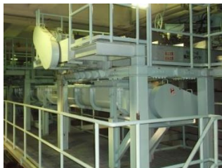
新河岸川水循環センター 汚泥搬送設備
