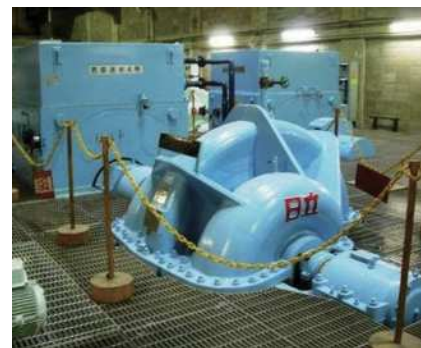
大久保浄水場の送水ポンプ
