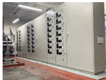
沈でん池設備コントロール
