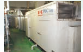
大久保浄水場排水処理施設の常用発電機
