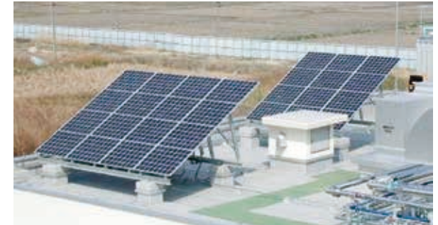
大久保浄水場の太陽光発電設備 平成20年度設置
