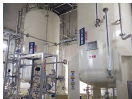
柿木浄水場硫酸設備 貯槽・注入設備
