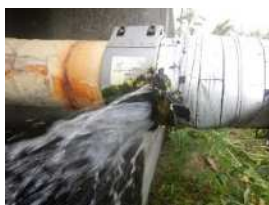
写真 6 漏水事故の様子
