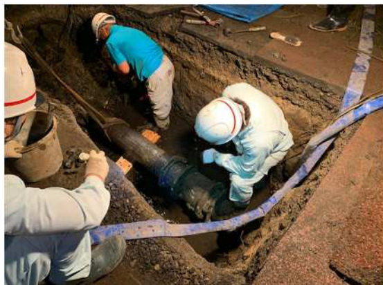
写真 2 漏水事故対応の様子
