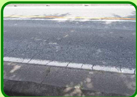
舗装の修繕 (施工前)
