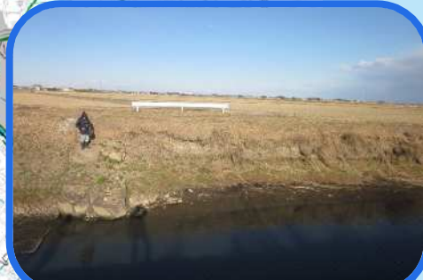
堤防の洗堀状況（最下流部）
