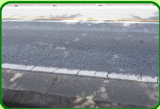
舗装の修繕前
