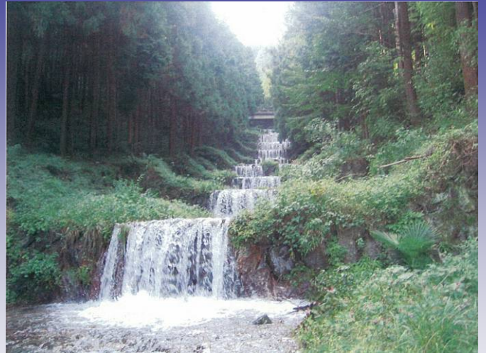
10段の階段状堰堤。周辺は植林の手入れがなされている。写真最上部に林道の橋梁が見える。
