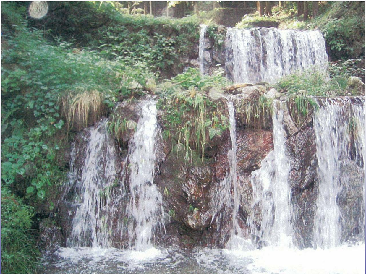
谷積に建造された堰堤部。堤体幅は10～15m程度が多い。積石は \phi 0.5 \sim 0.7 m級で水通しの底辺形状は水平。袖部の取付は台形と袖無しがはっきりしない。
