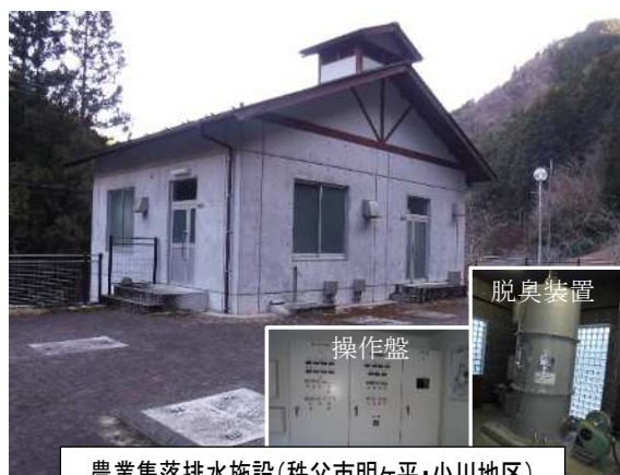
農業集落排水施設(秩父市明ヶ平・小川地区)
