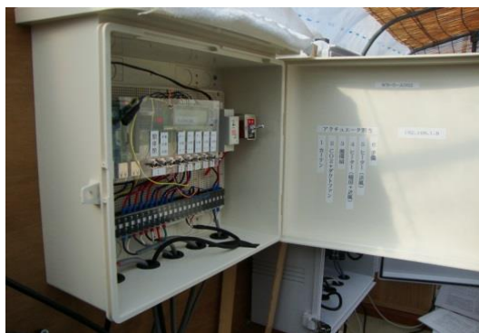
写真1 UECSのシステム制御盤
