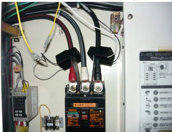
図3 電流測定器（CT設置）
