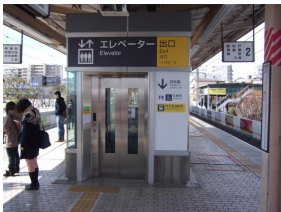
エレベーター（改札内）
