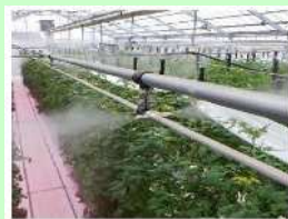
細霧冷房装置
