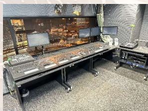
大ホールの照明等操作卓 (操作性、設備動作性の追求)
