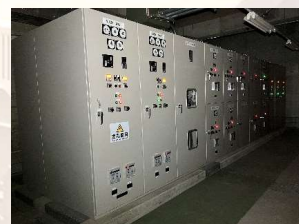
トップランナー型変圧器の採用 (省エネルギーに配慮)
