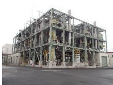
固形燃料化施設200t/日 下水道資源の有効活用
