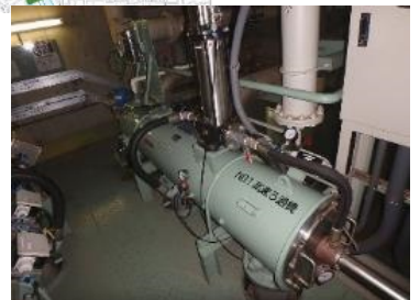
さいたま新都心浄化プラント 再生水供給施設を改築予定
