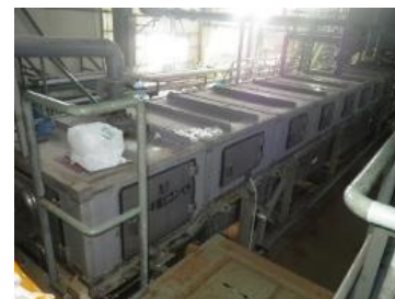
老朽化した汚泥搬送設備 更新時に臭気対策も実施
