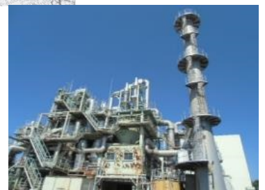
焼却炉100t/日×1基、50t/日×2基 老朽化した1,2号炉の更新を実施
