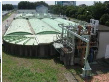
水処理1.5系列が稼働
