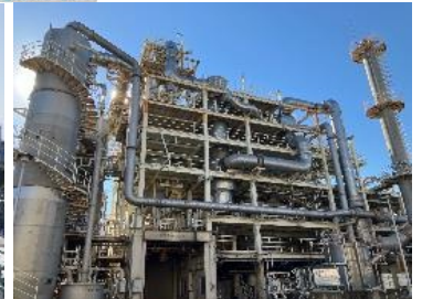
焼却炉4基(110t,140t,250t/日×2) 老朽化した2号炉を更新予定
