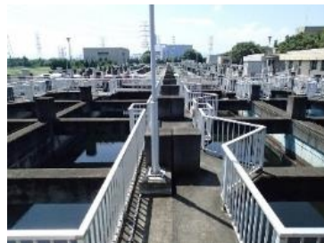
水処理2系列が稼働
