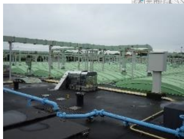
水処理8系列が稼働
