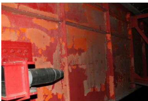
橋桁劣化事例
