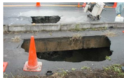
県管理道路における陥没事例
