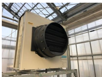
ヒートポンプ夜冷
